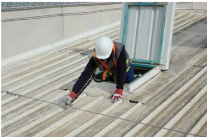
Línea de anclaje: acceso a cubierta
