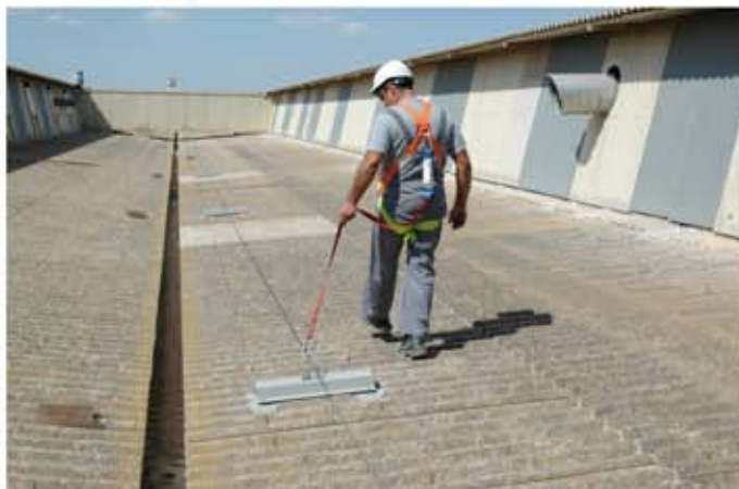
Línea de anclaje fijada sobre cubierta de fibrocemento con placas especiales
